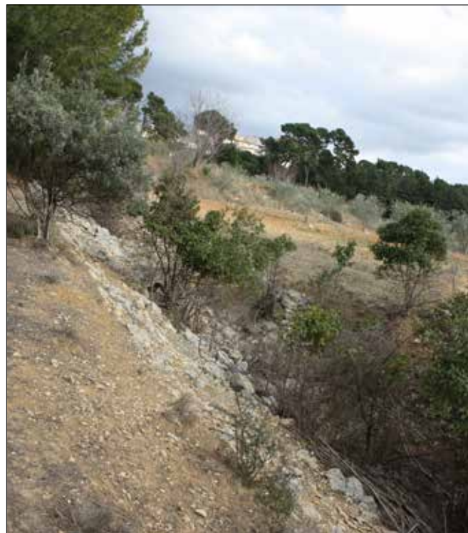
Chemin effondré sous la croix de la Reynarde. Photo P. Colombier.
